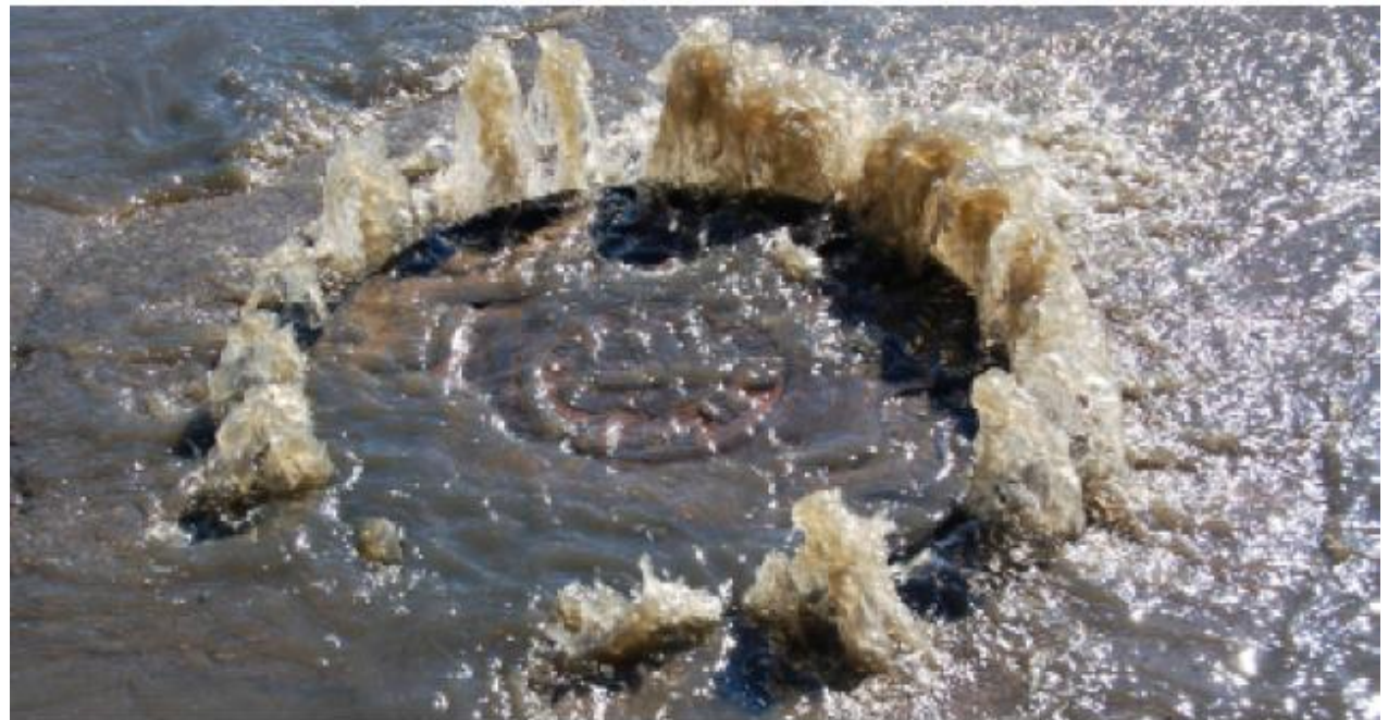
Bei Starkregen kann es zu einem Rückstau im Kanalsystem kommen und damit zu Überschwemmungen.
